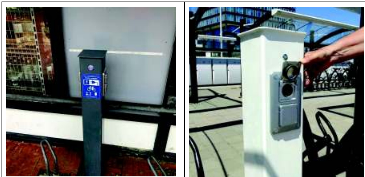
Ενδεικτικός Σταθμός φόρτισης
